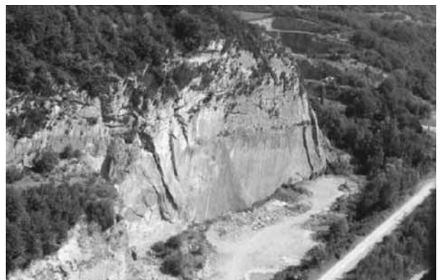
Photo 2. La falaise avant le début du chantier de construction (cliché CETE de Lyon).
