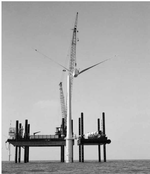
Photo 2. Les éoliennes de North Hoyle (cliché Vestas).
