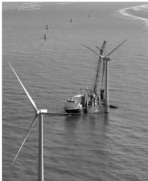
Photo 1. Collier pré-soudé installé à Scroby Sands (cliché Vestas).
