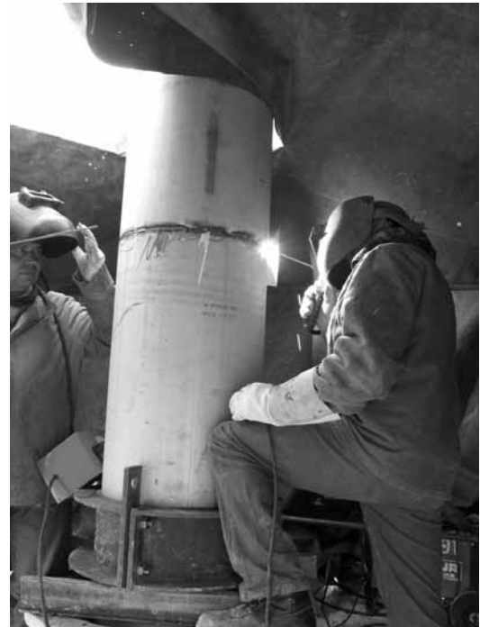
Photo 1. Mise en place d'un tubage de diamètre 457 mm dans un forage profond d'eau potable. Ultérieurement, un laitier de ciment, injecté sous pression entre l'extrados de ce tube et les formations imperméables séparant les deux nappes, permettra d'assurer l'isolation internappes. La pompe immergée sera ensuite logée à l'intérieur de ce tube qui constituera alors la chambre de pompage du forage.
