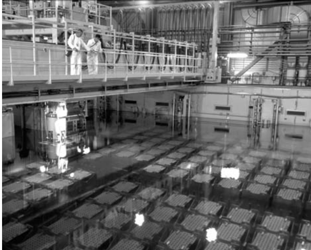
Photo 9. Piscine E, entreposage des combustibles usés. Usine de traitement des combustibles usés COGEMA-La Hague (cliché AREVA/Philippe Lesage).
