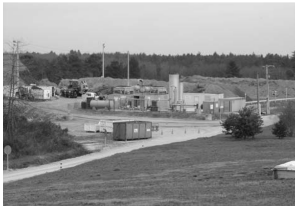
Photo 1. Vue de l'installation de valorisation du biogaz à Mézières-lez-Cléry (cliché G. Sustrac).
