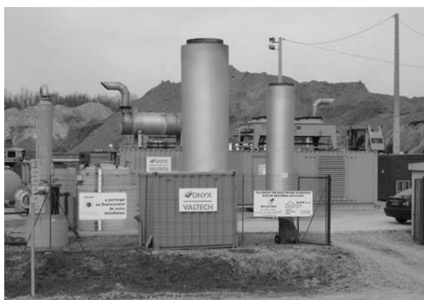
Photo 2. Vue de proximité de l'installation de valorisation du biogaz à Mézières-lez-Cléry (cliché G. Sustrac).
