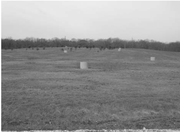
Photo 3. Vue de puits de collecte de biogaz à Mézières-lez-Cléry (cliché G. Sustrac).
