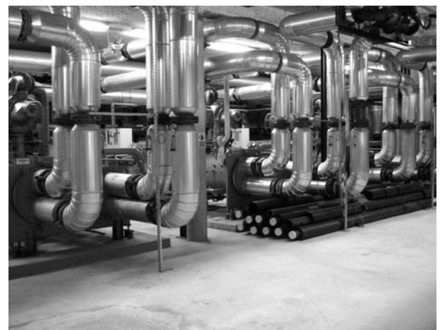
Photo 3. Une vue des pompes à chaleur (cliché G. Sustrac).
