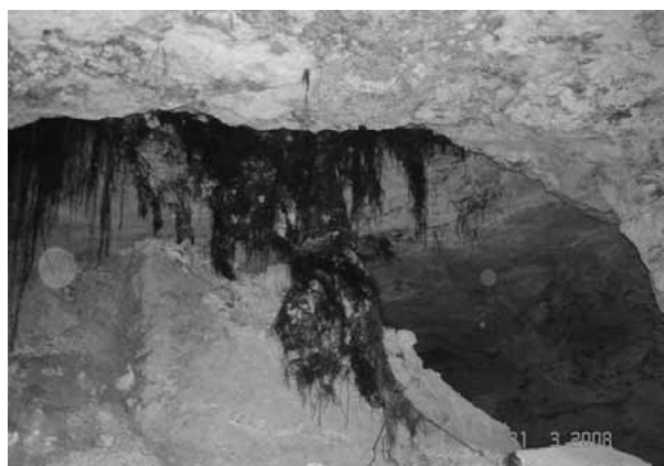
Photo 1. Exemple d'effondrement en carrière (© Ville d'Orléans, Service des Risques urbains).
