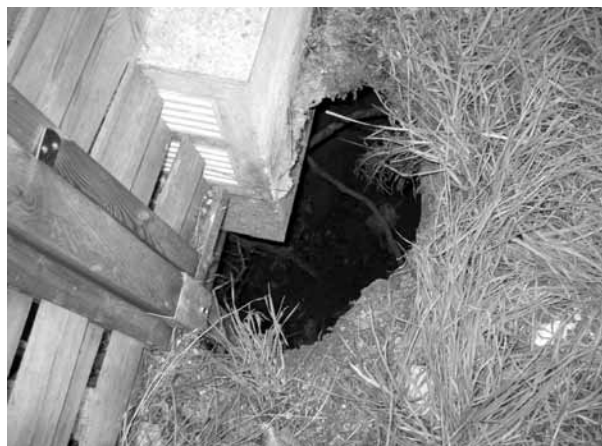
Photo 2. Exemple d'affaissement (© Ville d'Orléans, Service des Risques urbains).
