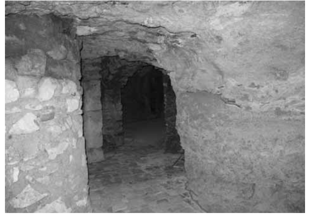
Photo 3. Exemple de confortement de carrière souterraine (© Ville d'Orléans, Service des Risques urbains).
