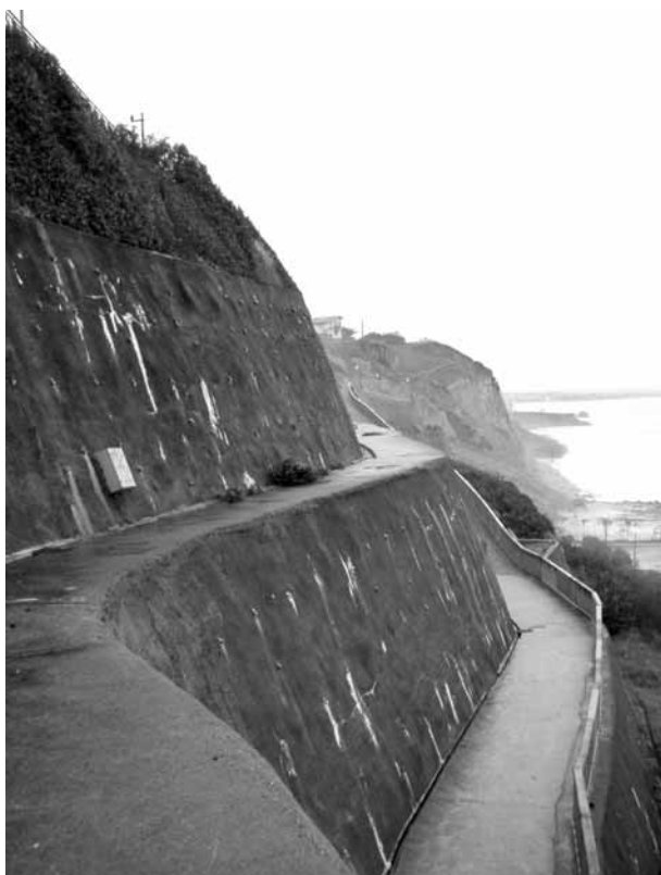
Photo 5. Exemple de mur clouté (cliché ANTEA).
