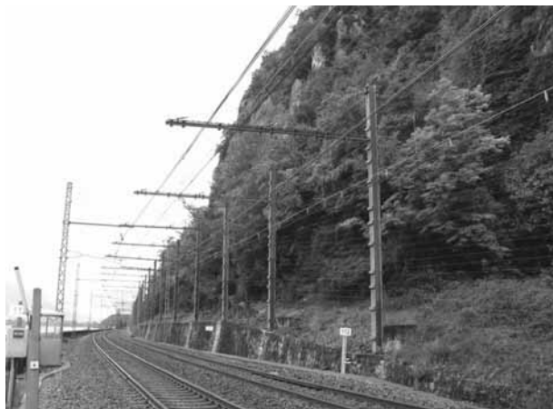
Photo 6. Filets détecteurs verticaux et horizontaux sur poteaux métalliques (cliché SNCF).
