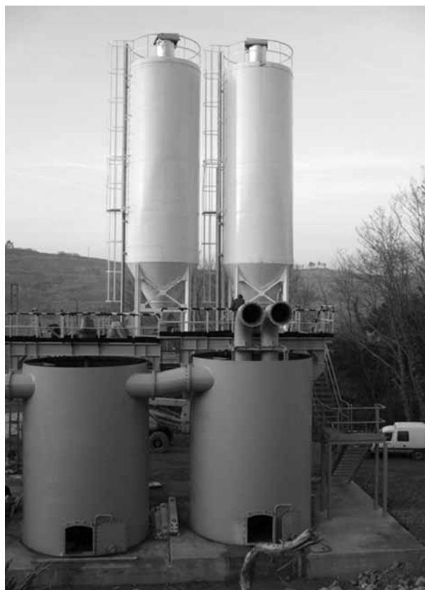
Photo 5. Installation de traitement des eaux pompées dans la carrière.
