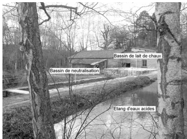
Photo 3. Les vieilles installations de traitement des eaux. État 2001 (cliché Françoise Aye-Barthélémy, BRGM).
