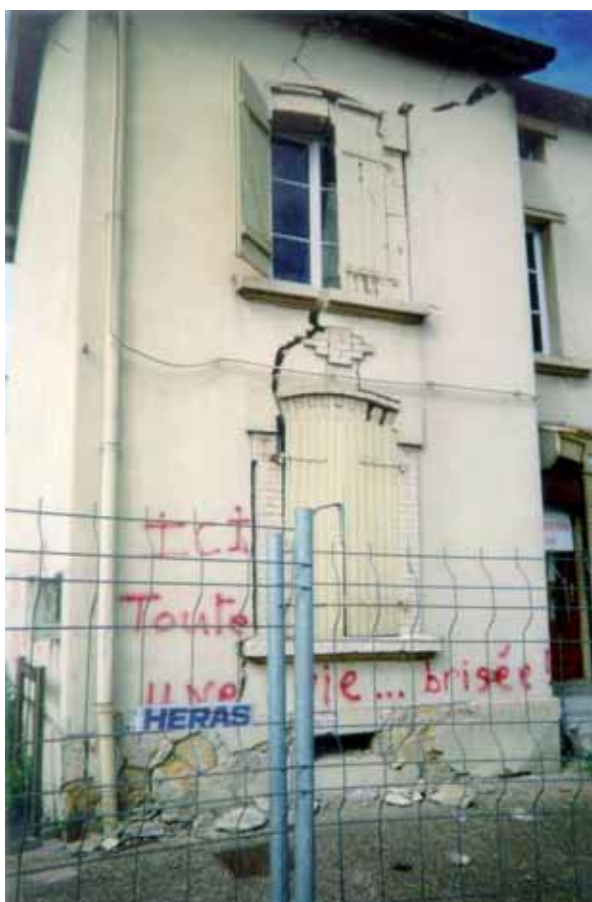
Affaissement minier à Auboué (Meurthe-et-Moselle, 1997) : maison lézardée (photo Brgm)
